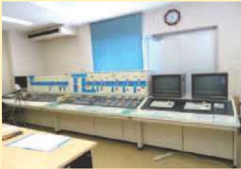
【改修前】 (中央管理所)
