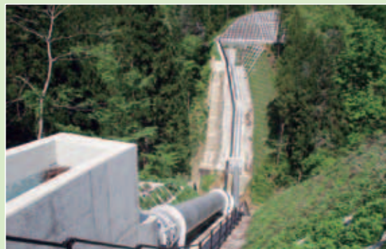
供用開始した北沢サイホン
