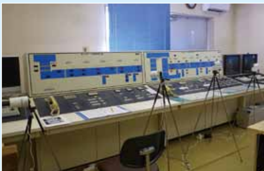
水管理設備・中央管理所
