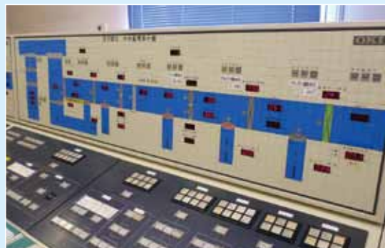
操作卓（故障が発生しても、交換部品の調達が困難）
