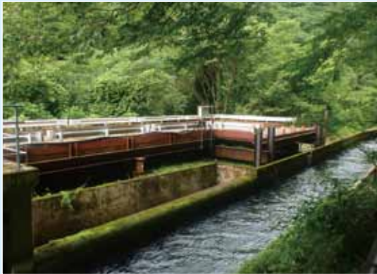
重機及び資材を水路内に降ろすための昇降架台設備
