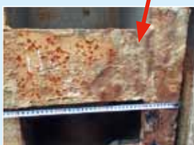
ゲートの発錆
