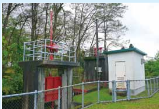
丸子川サイホン水位調整・放水ゲート
