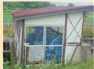
水位調整ゲート操作室の老朽化
