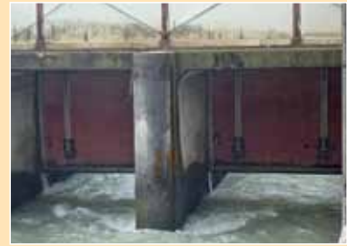
水位調整ゲート (塗装劣化)
